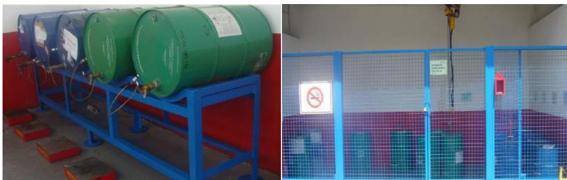
Figura 5: Infraestrutura de abastecimento da mistura B10.
