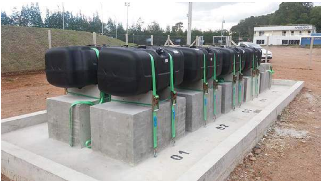
Figura 01 – Vista lateral da estrutura de armazenamento de combustível
